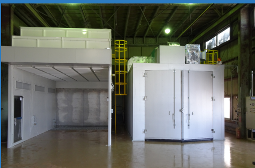
塗装ブース・焼付乾燥炉
